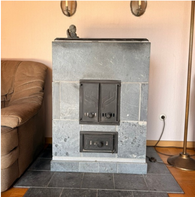
Kamin / Ofen Wohnbereich
